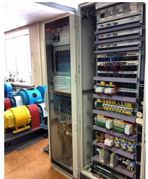
Рис. 6 – Общий вид стойки автоматики
